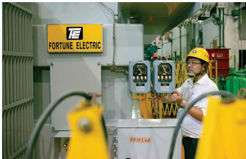
變壓器是電力供應系統的關鍵，華城電機員工總是細心地檢查、巡視，並且不斷測試。
